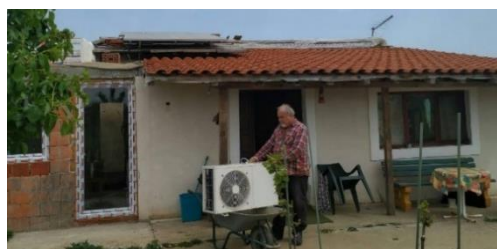
Primopredaja toplotne pumpe
